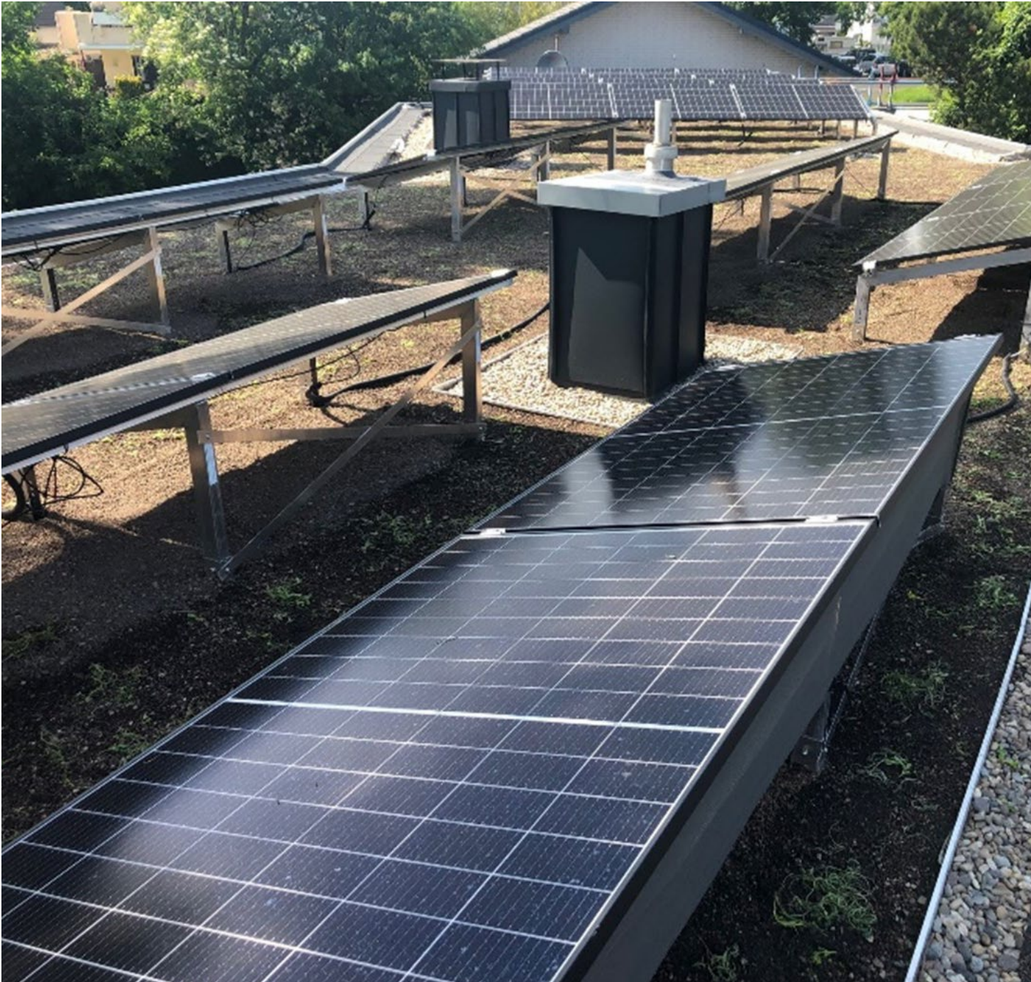
Abbildung 5: Eine gute Kombination: Gründach und Solaranlage; Zeitpunkt kurz nach der Aussaat (Quelle: Umwelt- und Verbraucherschutzamt, Stadt Köln)
