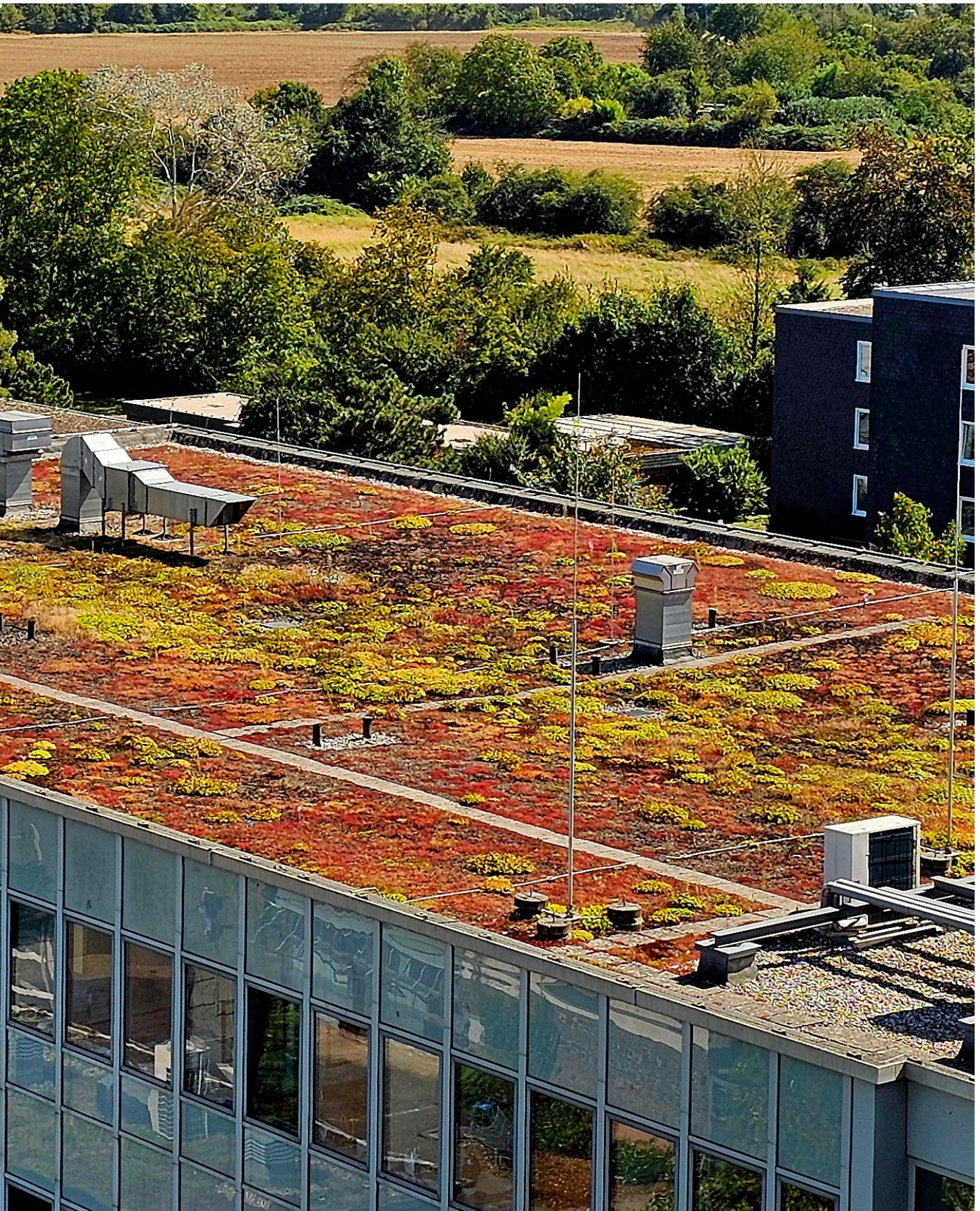
Abbildung 2: Extensive Dachbegrünung (Quelle: Umwelt- und Verbraucherschutzamt, Stadt Köln)
